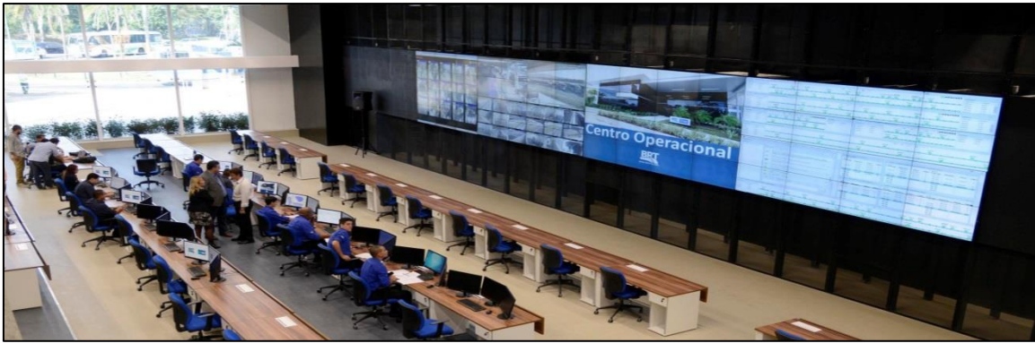
Figura 16 - Centro de Controle Operacional do BRT
