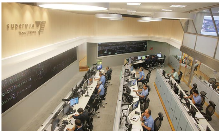
Figura 15 - Centro de Controle Operacional da Supervia Fonte: SUPERVIA, 2013.
