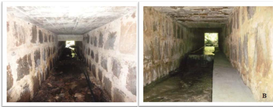
Figura 6.1: Drenagem da pista da BR 116/RJ antes da adequação para Passagem de Fauna.
