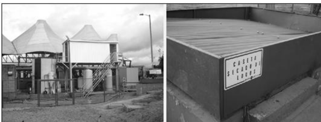
Figura 4.16: Infra-estrutura para Gestão de Recursos Hídricos no Pátio da Express Del Futuro
