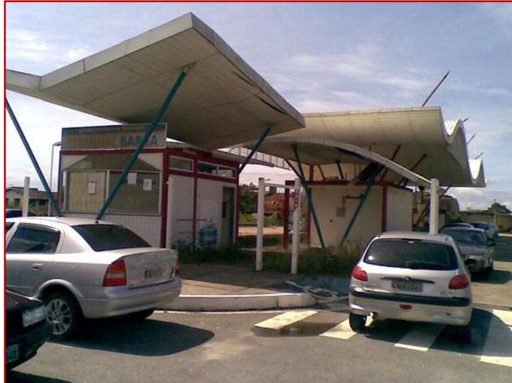
Figura 73 - Fotografia do acesso de usuário e ônibus no Terminal Barra, atualmente desativado.
